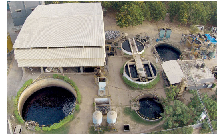
Effluent Treatment Plant (ETP)
