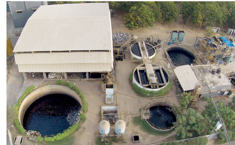
Effluent Treatment Plant (ETP)
