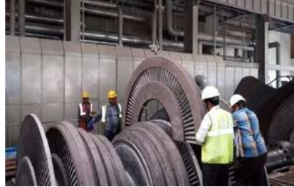
TG Overhauling 600 MW Jharsuguda Vedanta
