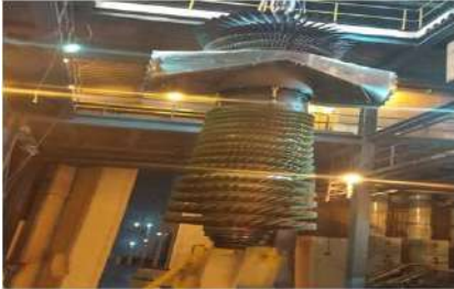
Siemens -138 MW Gas Turbine Paguthan
