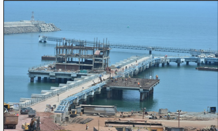
LNG Terminal at Jaigarh
