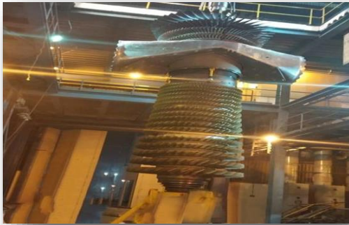
Siemens -138 MW Gas Turbine Paguthan
