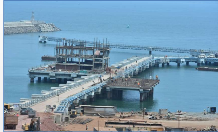
LNG Terminal at Jaigarh
