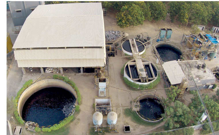
Effluent Treatment Plant (ETP)
