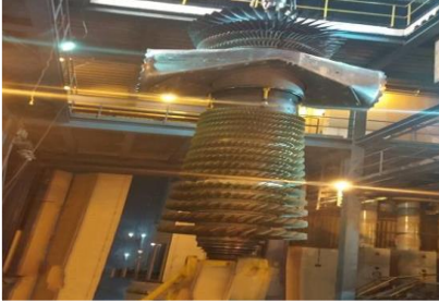
SIEMENS -138MW GAS TURBINE PAGUTHAN
