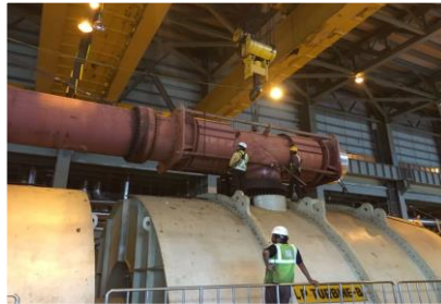
TURBINE AOH, 600 MW UDIPI
