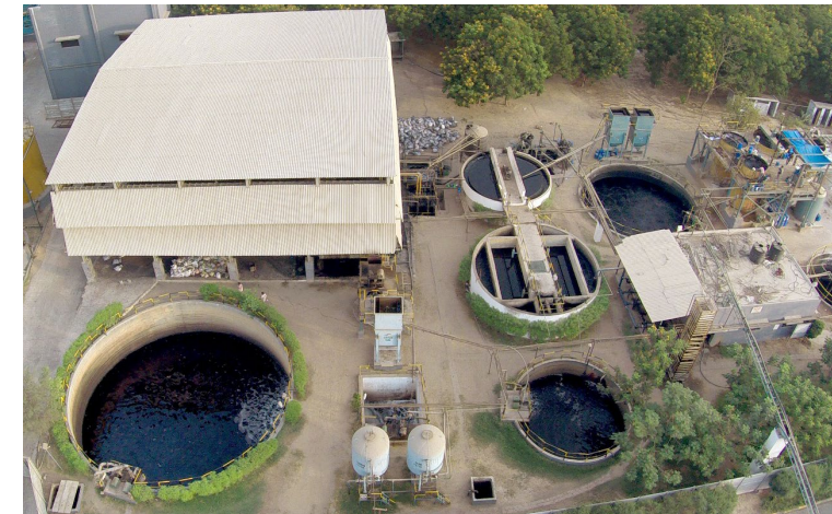
Effluent Treatment Plant (ETP)
