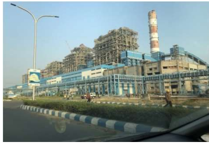
3x660 MW Barh STPP, NTPC
