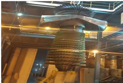
Siemens -138 MW Gas Turbine Paguthan
