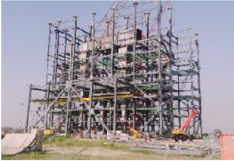
1X660 MW TPP, BTG, HARDUAGANJ, DOOSAN
