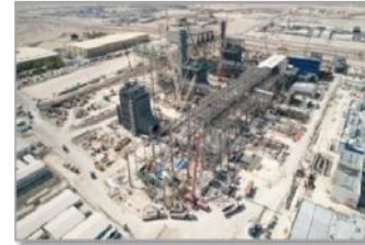
1800 MW ALBA CCPP, BAHRAIN ETC OF GTG,STG,HRSG & BOP
