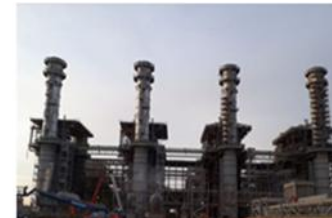
1390MW WAAD AL SHAMALCCPP, SAUDI ARABIA ETC OF HRSG
