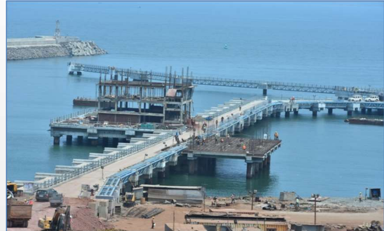
LNG Terminal at Jaigarh
